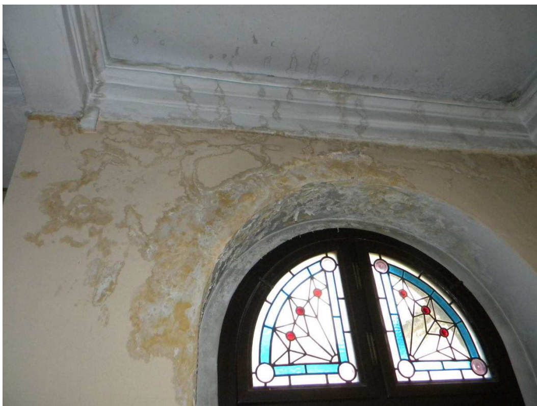
fot.4. Widok zacieków na ścianie korytarza.
