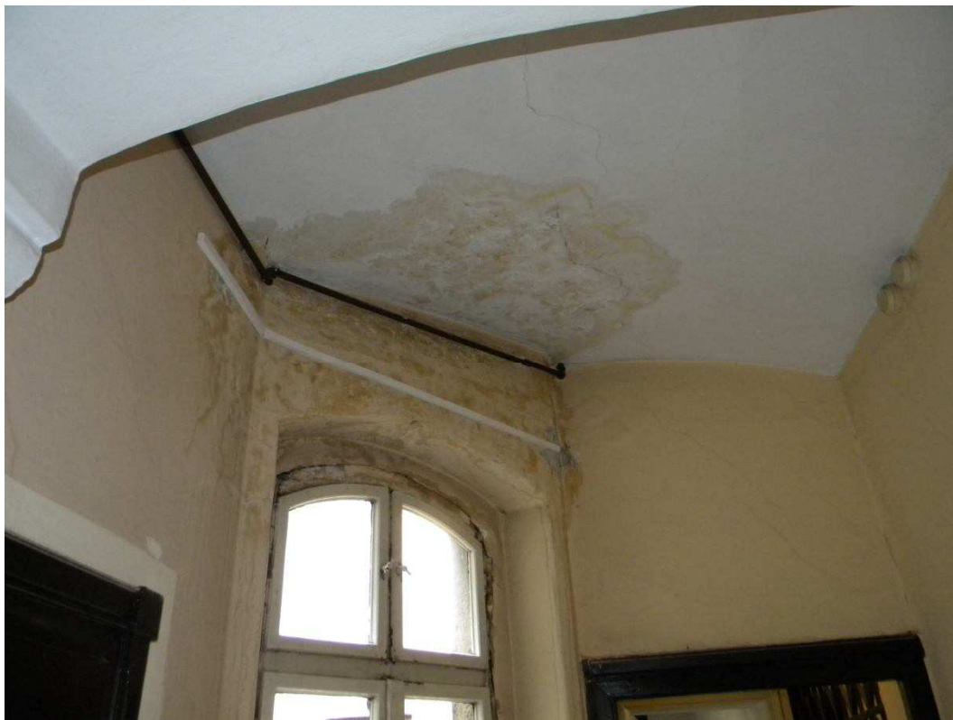
fot.5. Widok zacieków sufitu i ściany korytarza.
