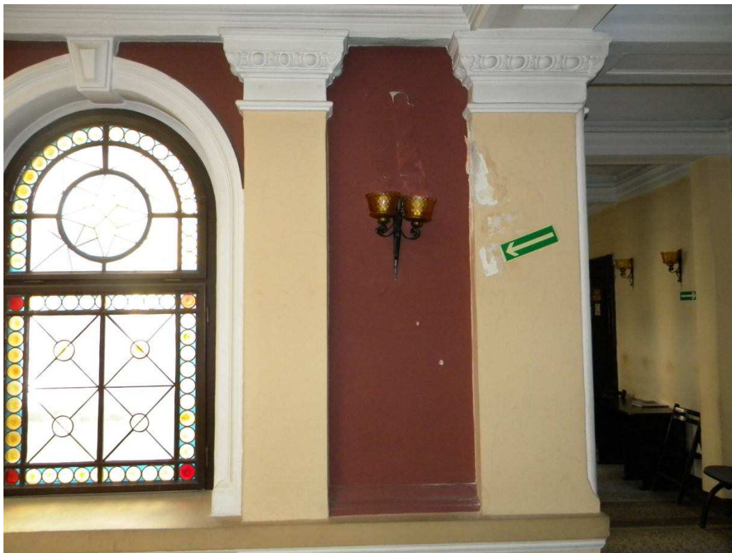
fot.3. Widok uszkodzonej powłoki malarskiej korytarza
