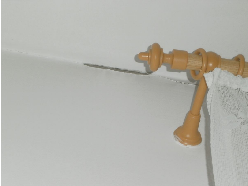
fot.5. Widok uszkodzeń powłoki malarskiej kuchni mlecznej grupy I.
