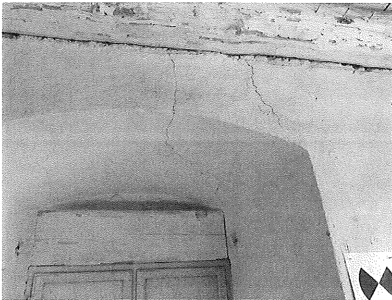
F79. Parter. Pęknięte nadproże.
