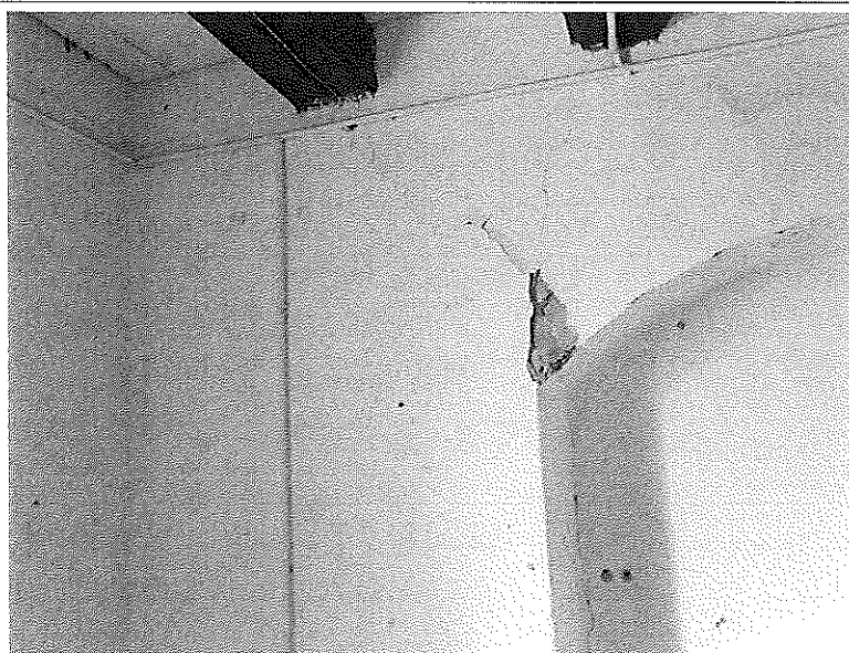
F60. Parter. Pionowe rysy na ścianie. Pęknięte nadproże.
