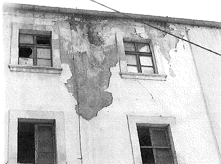
F14. Elewacja frontowa. Rysy na murze. Liczne ubytki tynków.
