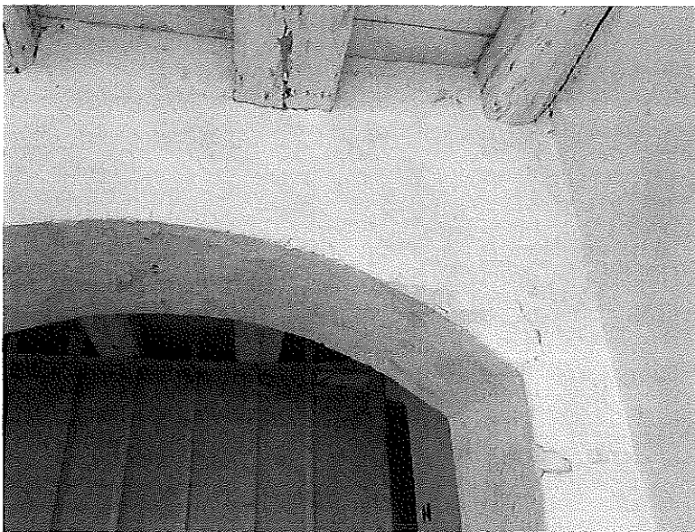
F80. Parter. Pęknięte nadproże.
