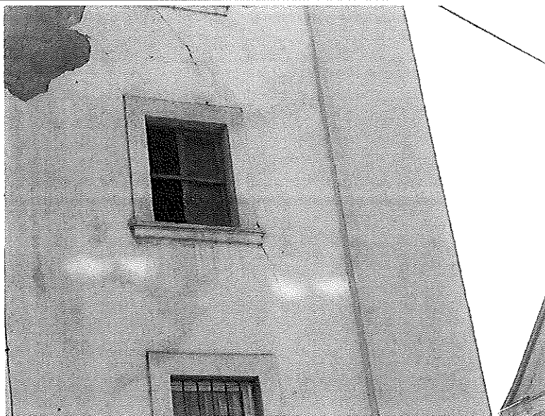
F13. Elewacja frontowa. Rysy na murze.
