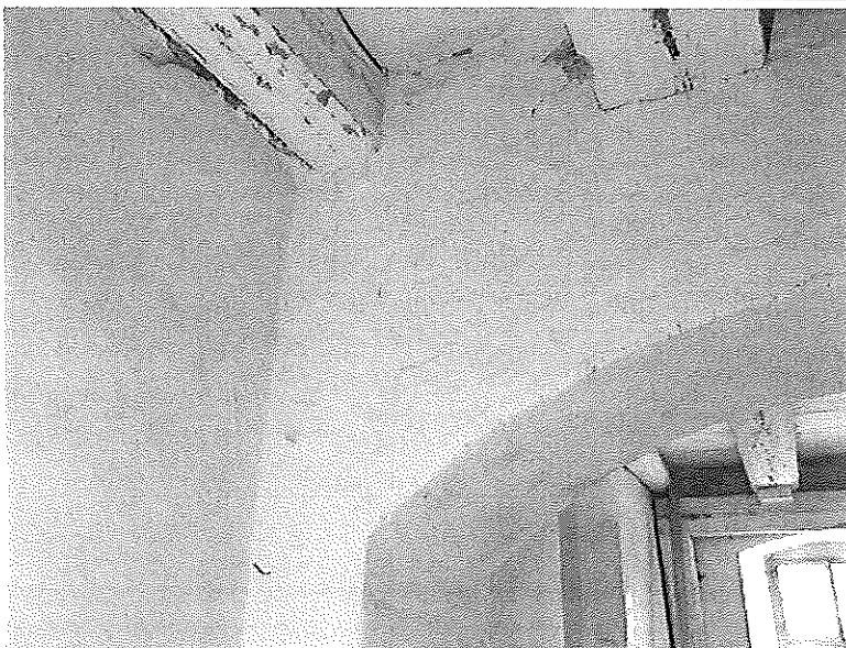
F81. Parter. Pęknięte nadproże oraz folar.
