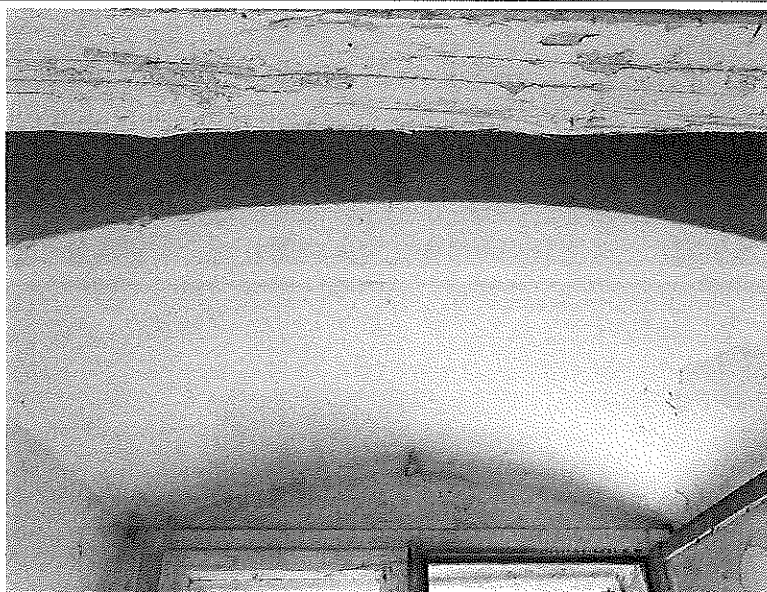
F76. Parter. Pęknięte nadproże.
