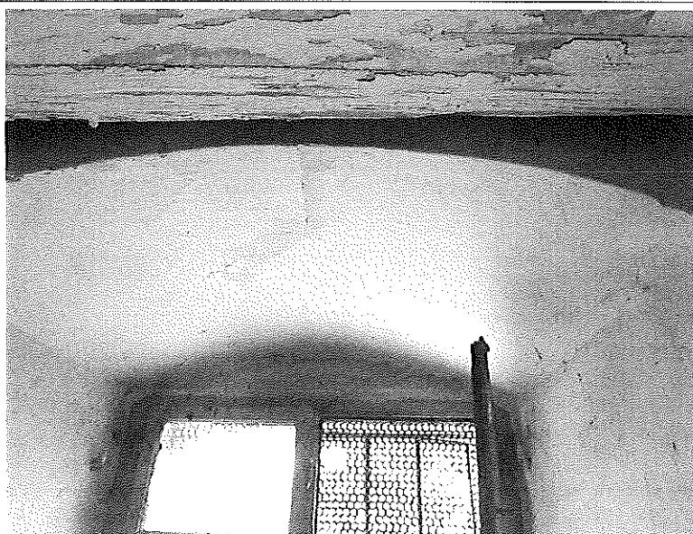
F78. Parter. Pęknięte nadproże.
