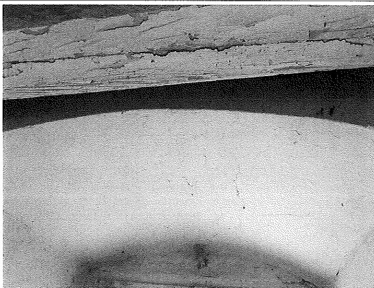
F77. Parter. Pęknięte nadproże.
