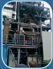
W instalacji tej, zrębki drewna zostają zamieniane w prąd i ciepło.
