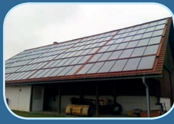
Na dachu kolektory słoneczne a w środku kocioł na zrębki. Na niepozorna stołba w małej miejscowości zaopatruje w ciepło 250 mieszkańców
